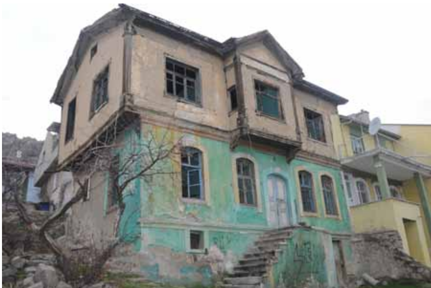
Bayatlı Arif Bey'in geçtiğimiz günlerde yıkılan evi
